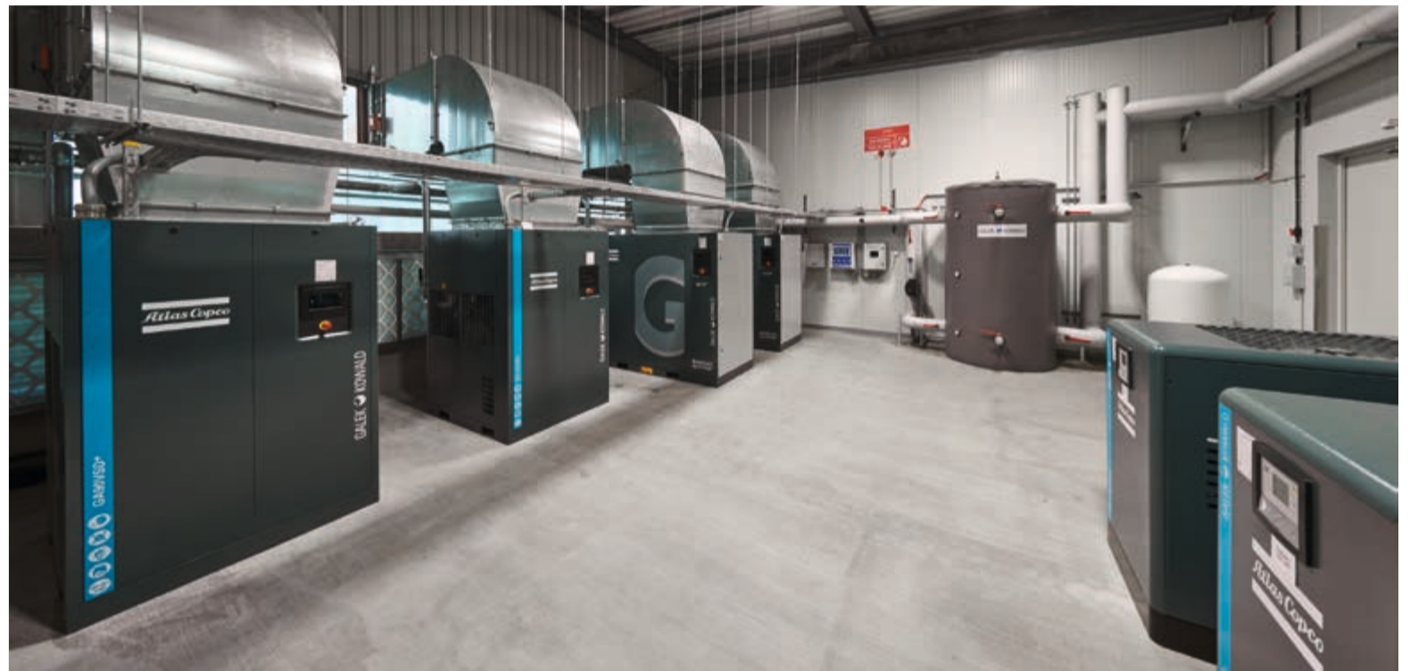
Druckluftherzeugung mit Wärmespeicher
