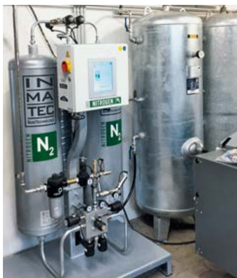
Der neue Stickstoffgenerator.
