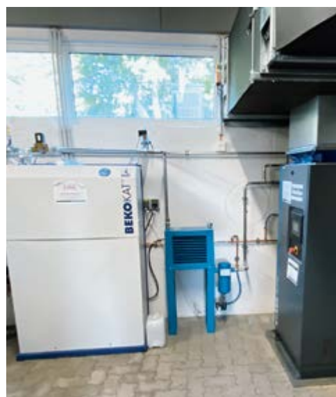
Katalytischer Konverter mit Nachkühler, rechts der neue Schraubenkompressor.
