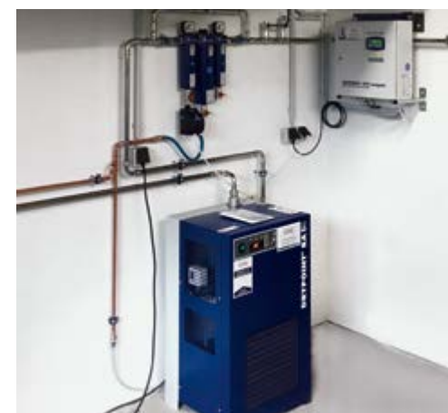
Restölüberwachung (Monitoring oben rechts) sowie Kältetrockner und Filter
